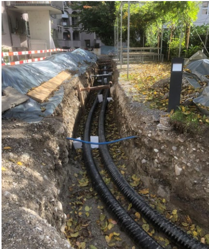
Anschlussleitung zu unserer Siedlung 3
