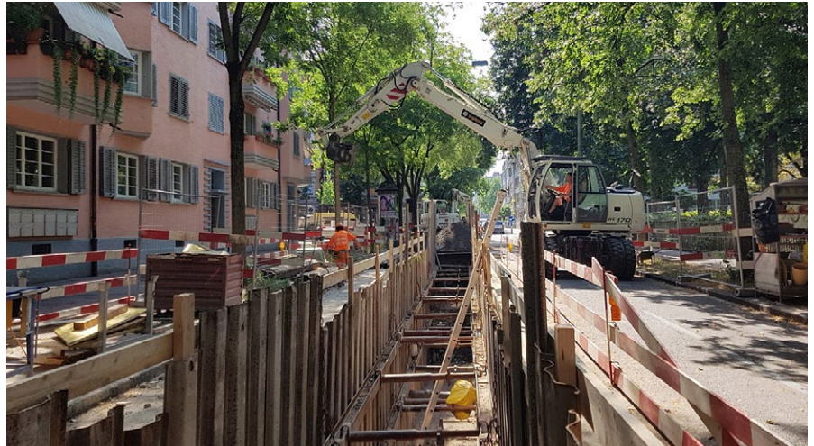
Die Leitungen entlang der Josefstrasse wurden in einem bestehenden Kanal sowie in einem knapp 400 m langen offenen Graben verlegt.
