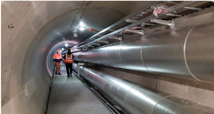
Für die total 6,5 km lange Verbindungsleitung wurde ein neuer, 2,5 km langer unterirdischer Microtunnel gebaut.
